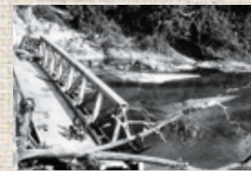
ビアフラをめぐる内戦で破壊されたトラス橋
