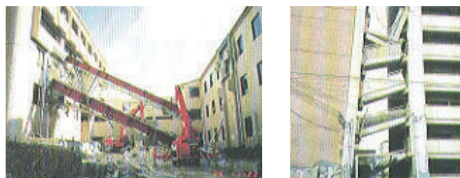
図4 建物接合部の被災
