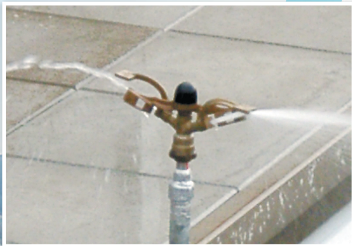
散水スプリンクラー
