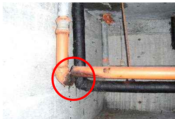
↑ 腐食による屋内排水管の水もれ
