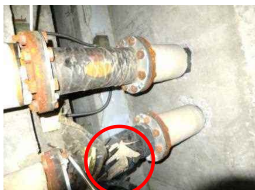
↑ 経年劣化によるフレキシブルジョイントの破裂
