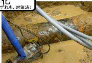
配管からの漏水
