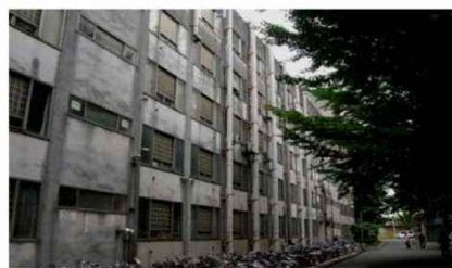
外壁・建具落下の危険
