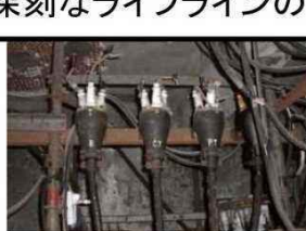
電気ケーブルの劣化
