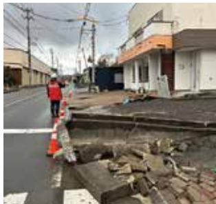
2024年能登半島地震による液状化被害調査
