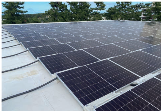
第一体育館屋根の太陽光パネル
