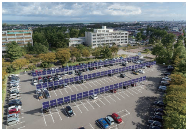
旧正門脇駐車場の太陽光パネル
