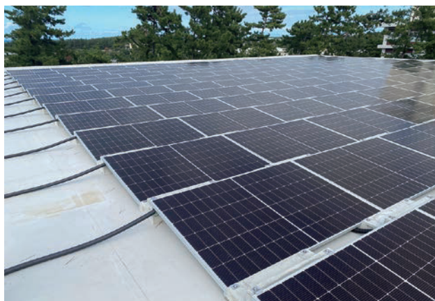
第一体育館屋根の太陽光パネル
