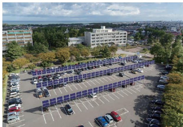
旧正門脇駐車場の太陽光パネル
