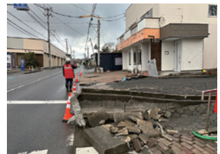
2024年能登半島地震による液状化被害調査
