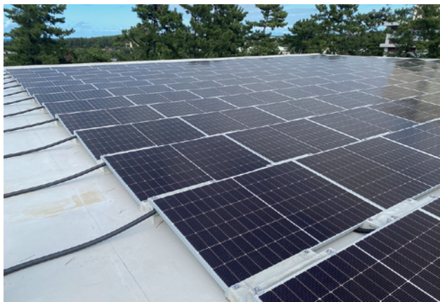
第一体育館屋根の太陽光パネル
